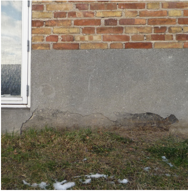
Skade på sokkel
