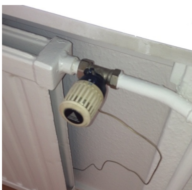
Gl. radiator og termostat
